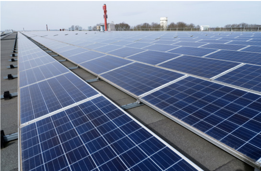
Het dak van een fabriek met zonnepanelen
