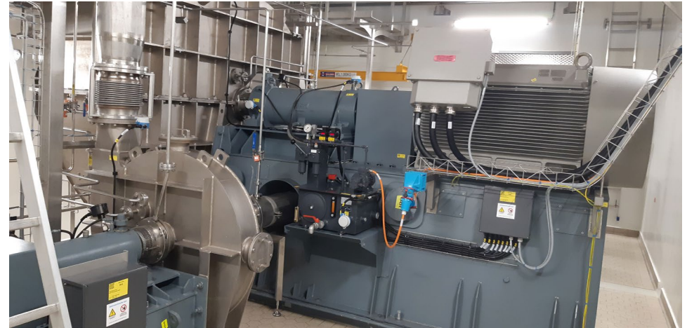
Ventilator en systeem onderdeel van een MVR-installatie
