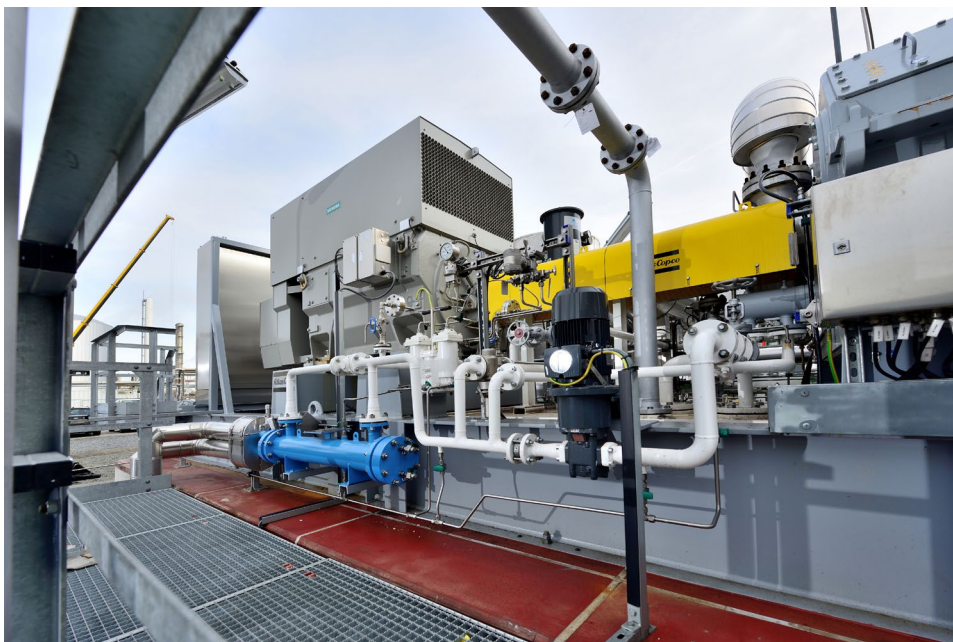
Stoomrecompressor Dow Terneuzen
