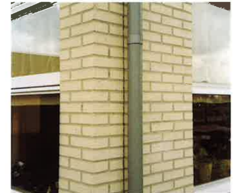
Metselwerkdilatatie achter HWA
