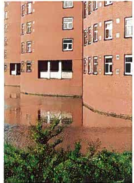
Figuur 16. Metselwerk in voortdurend contact met water
